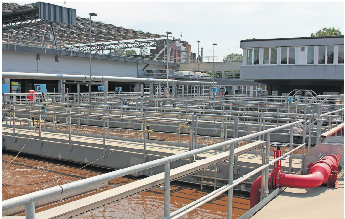
In der ARA Langmatt im aargauischen Möriken-Wildegg wird schon heute das Abwasser aus 15 Gemeinden der Grossregion Lenzburg gereinigt. Diese Anlage soll zur ARA Seetal erweitert werden.
